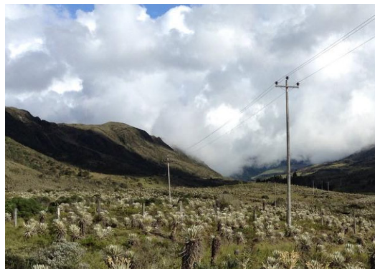
Torre de transmisión en el municipio Filandia, del proyecto Armenia entre los departamentos de Quindío y Risaralda
